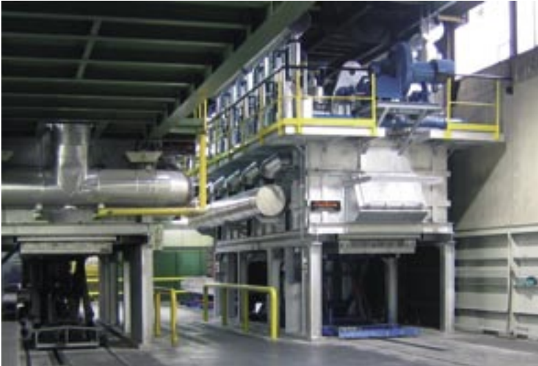
Haubenofenanlage · Homogenisieren von Aluminiumbolzen
