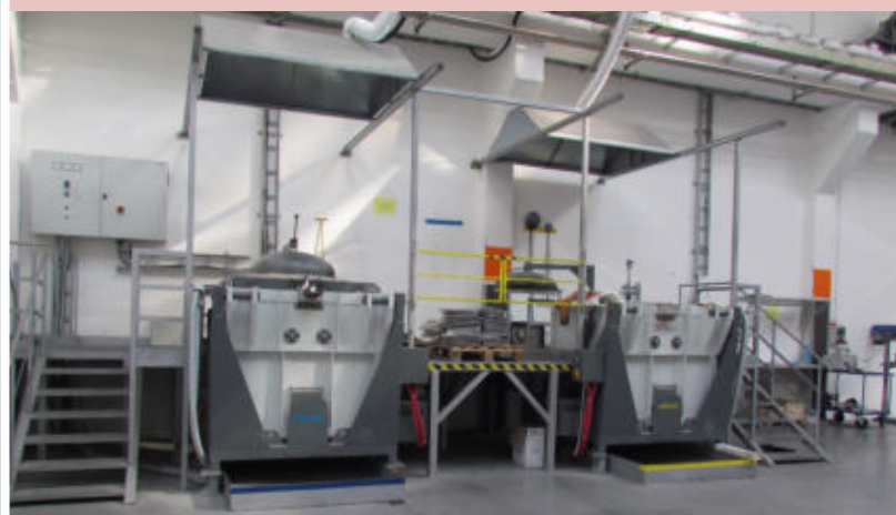
Produktionslinie bestehen aus 2 x TA 600/12/K, angepasste Arbeits- und Beschickungsplattform sowie verschiebbare Ablufthauben
